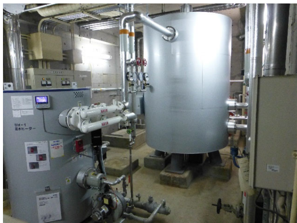
共用棟ボイラー（春日キャンパス）
