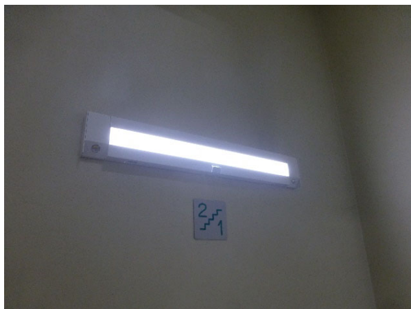
LED照明（階段非常照明）
